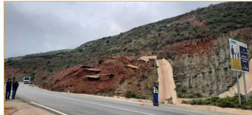
Glissement, RN16 (PK110) -Aouchtam, Tétouan
